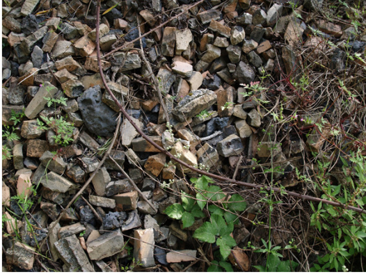
AMIANTO FRIABILE TRA I REFRATTARI
